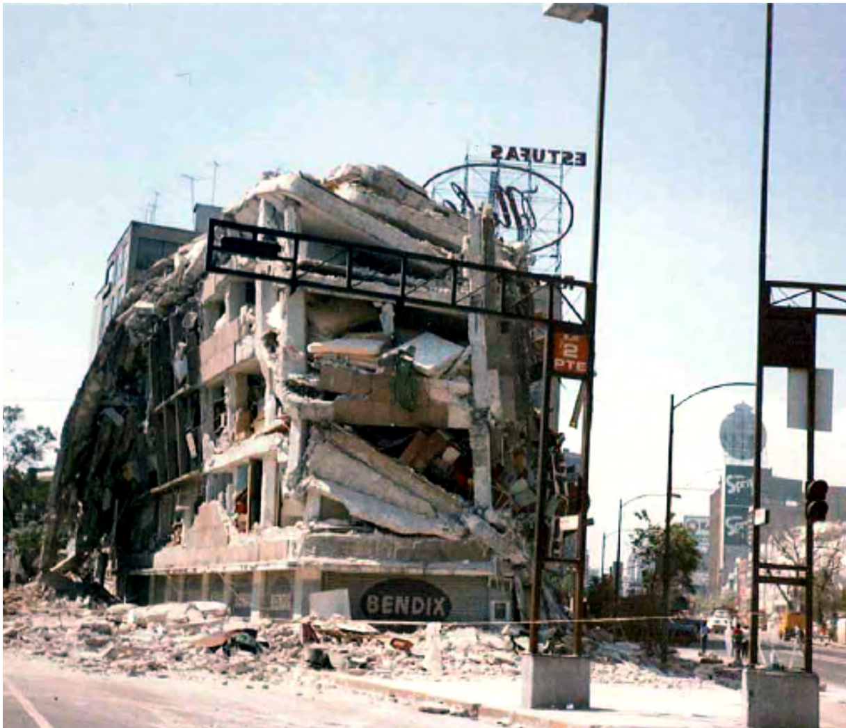
Edificio ubicado en la cuchilla de Álvaro Obregón, Insurgentes y Monterrey, afectado por el sismo de 1985 Fuente: Fotos compartidas por los miembros del comité y grupos de trabajo daños AMIS
