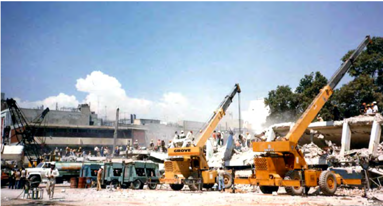
Trabajos de remoción de escombros de edificios afectados por el sismo de 1985
